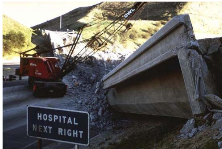
Abbildung 1: Brückeneinsturz nach dem San Fernando Erdbeben 1971 (Nielson, 2003)
